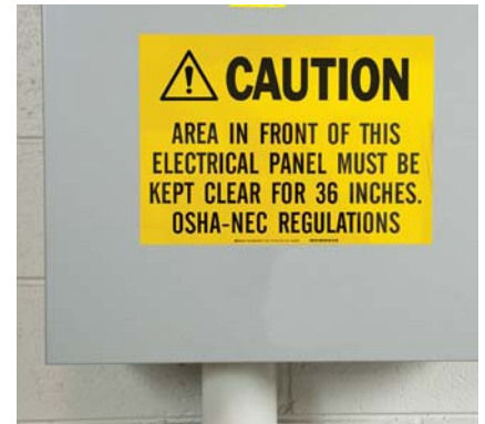
Panneaux d'avertissement des risques
